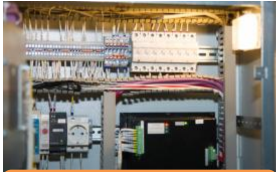
Верх шкафа управления
