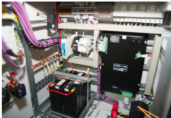
Низ шкафа управления
